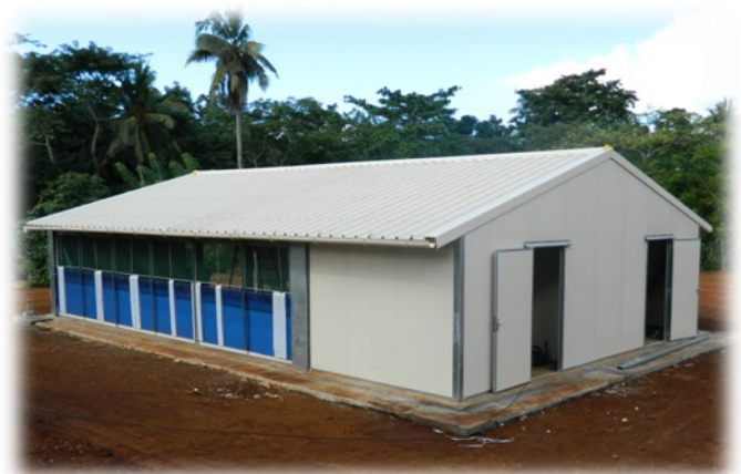
Bâtiment en cours de montage sur l'exploitation du lycée agricole de Coconi
